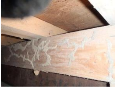
↑ 耐震診断時に床下で 蟻道発見
