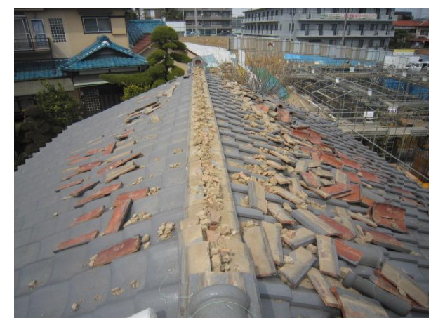
写真上：瓦の落下 (緑区)
